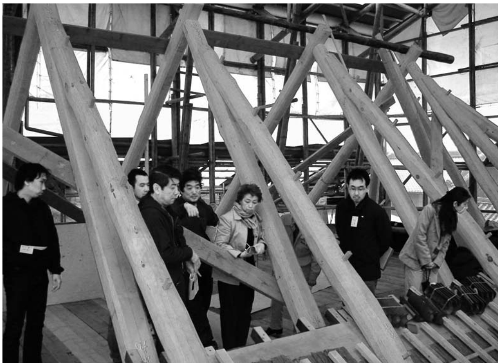
「伝統建築保存・活用マネージャー上級講座」では、伝統的な建築技術の習得も大切な課題。民家再生の現場で、「しころ葺き」※の小屋組の組み手を見学する ※ 兜（かぶと）の後頭部に垂れ下がる「しころ」のような形で2段になった屋根の葺き方
