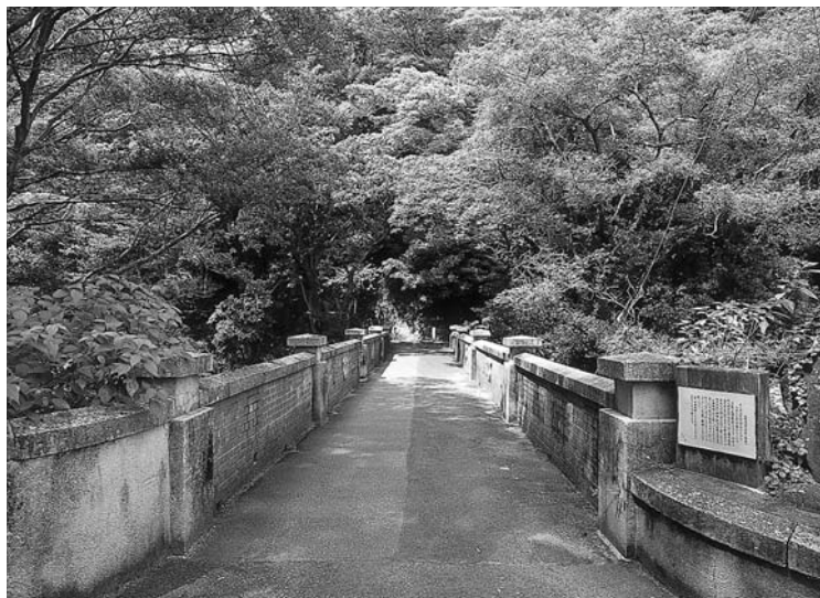
いかにも明治時代を思わせるレンガ積の砂子橋。 中を上水道管が走っている
