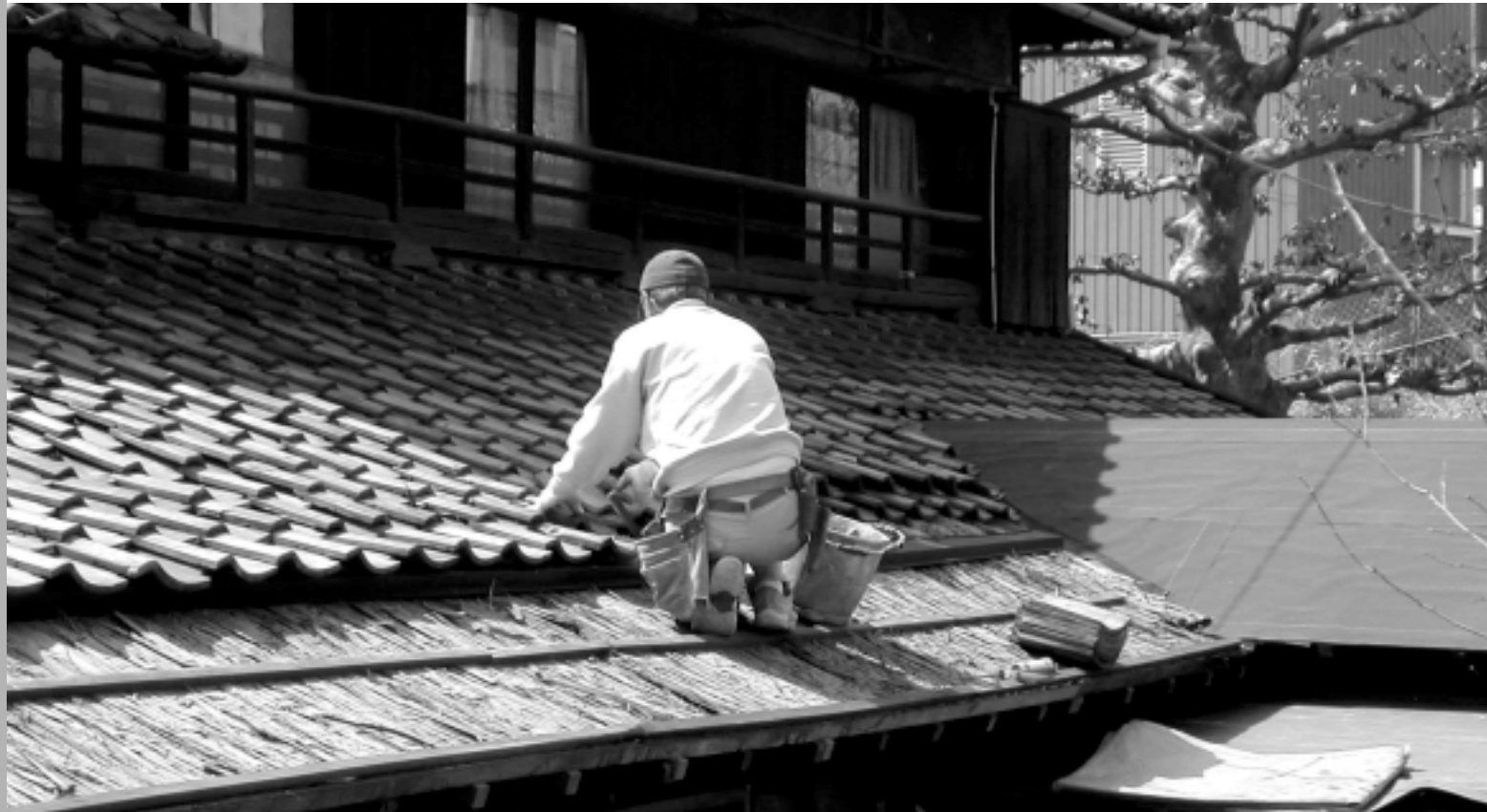
「屋根はプロにまかせないと大変なことになります」と矢野さんがいうように、久米邸では、前に誤った修理をしたことから屋根から雨漏りがするようになっていたが、専門家と組んで的確な修理を行った
