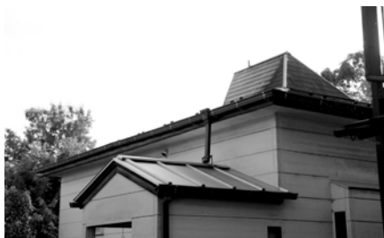
屋根にはスプリンクラーが設置されている。夏には雨水をここから噴射して、屋根を冷却する
