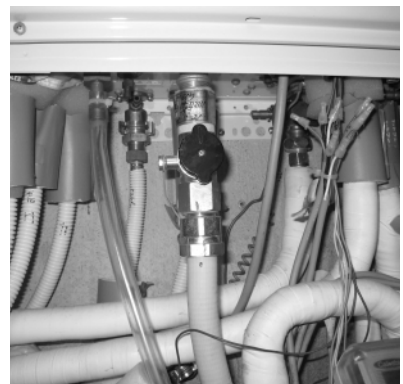
【写真10】 熱源機ヘッダー部分
