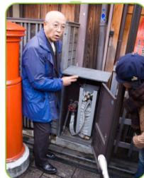
消火栓も歴史的まち並みとマッチするよう配慮して設置
