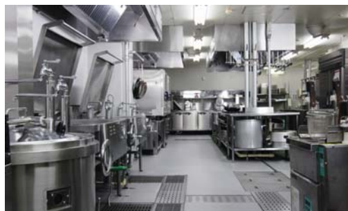
「涼厨」が導入されたドームシティガスビル15階の社員食堂厨房
