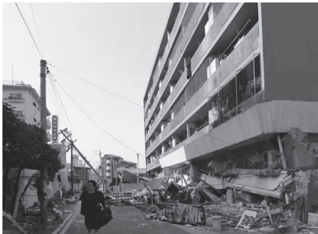
阪神・淡路大震災で被災した集合住宅。 写真提供／神戸市
