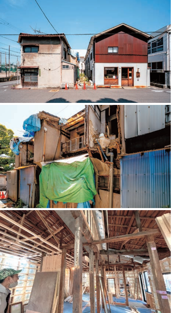
上／双子長屋の北棟（写真右）が「ヨリドコ大正メイキン」として再生された2017年当時の小川文化。現在「るつぽん」となっている南棟（写真左）は手つかずのまま。 中／2018年の台風21号により、居住困難な状態に。 下／地域の記憶を積み重ねる場所として残すため、建て替えることなくリノベーションが行われた。 写真提供／オルガワークス
