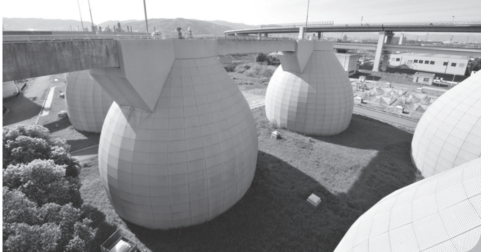
汚泥乾燥機。消化ガスと消化ガス発電機の熱を利用して脱水汚泥を乾かす(上図④)
