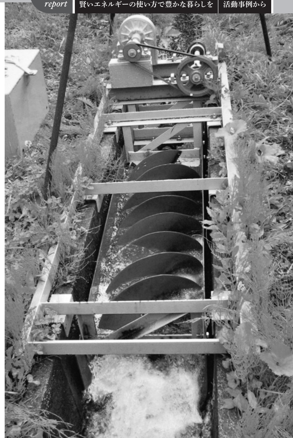
農業用水路に設置された「らせん水車」を用いたマイクロ水力発電機。水車の軸からチェーンとベルトで動力を取り出し、30Wの電気を生み出す(岐阜県揖斐川町坂内)
