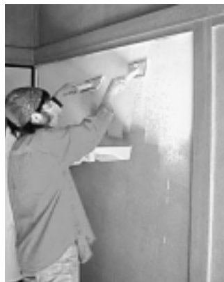
集合住宅の集会所のリニューアル風景。「セルフビルド」の一環として、理事会の人々が最終的な壁塗りなどの作業を自らの手で行っている
