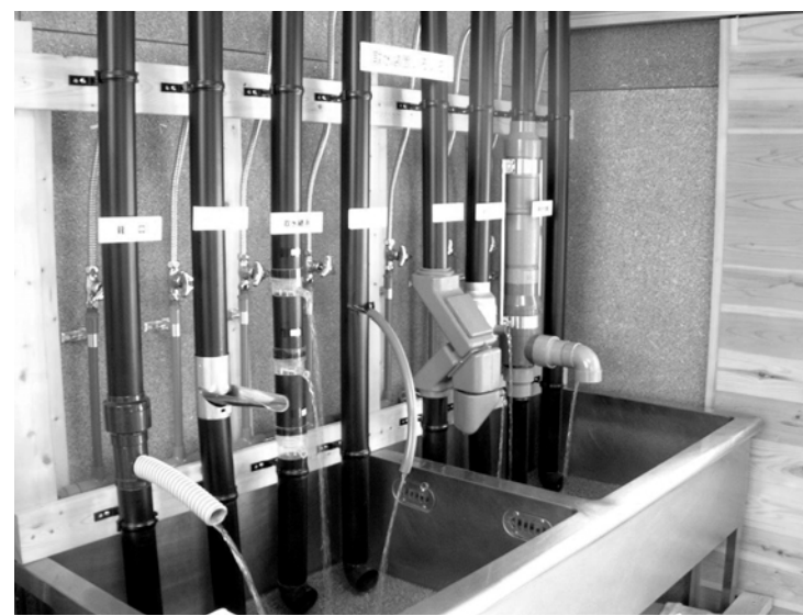
雨水ハウス内に展示された集水装置
